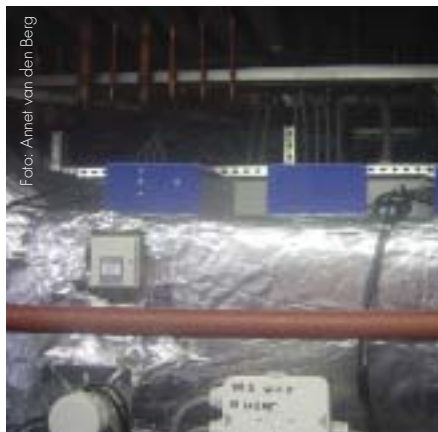
Enkele ionisatoren in de technische ruimte van het ziekenhuis.
